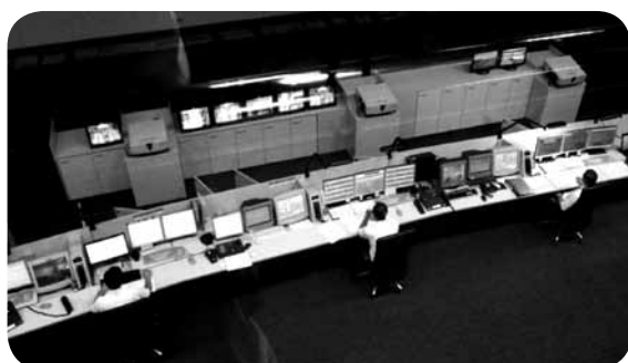
:: ห้อง CCR (Central Control Room) ควบคุมการเดินรถ
